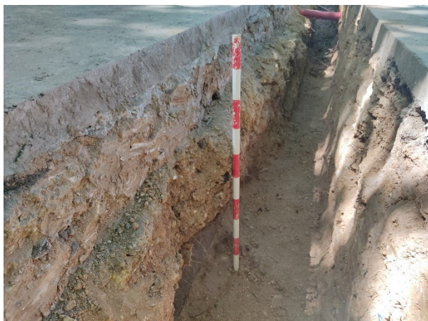
5. Perfil nord del tram oest de la rasa, on s'observa el paviment (UE 01), situat sobre les UE 02, 03 i 06. A més, en la part baixa hi ha el tub UE 07.
