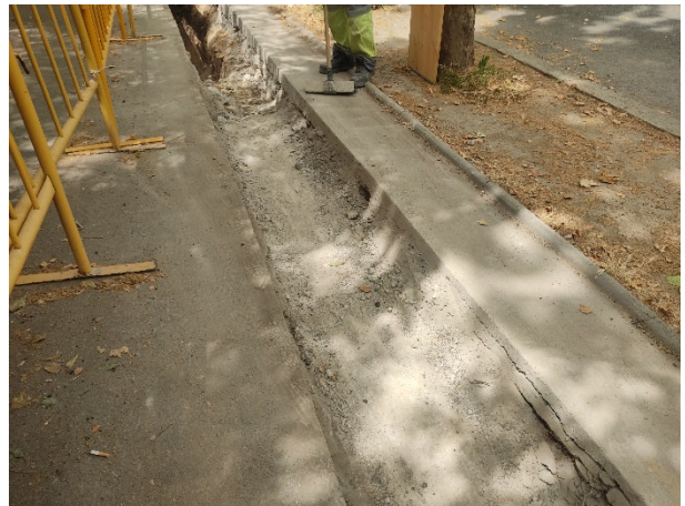
10. Part central de la rasa, on s'observa la preparació de paviment UE 02, després de la retirada del paviment actual.
